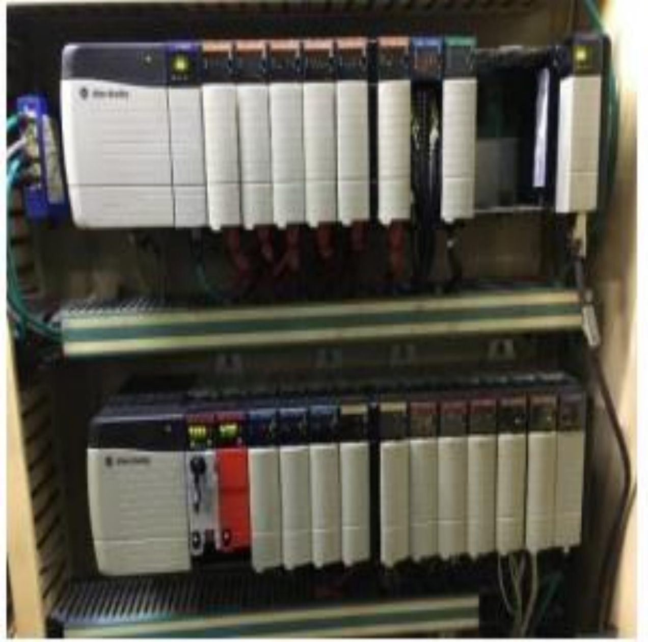
(b) PLC dönüşümü yapılmış kumanda sistemi
